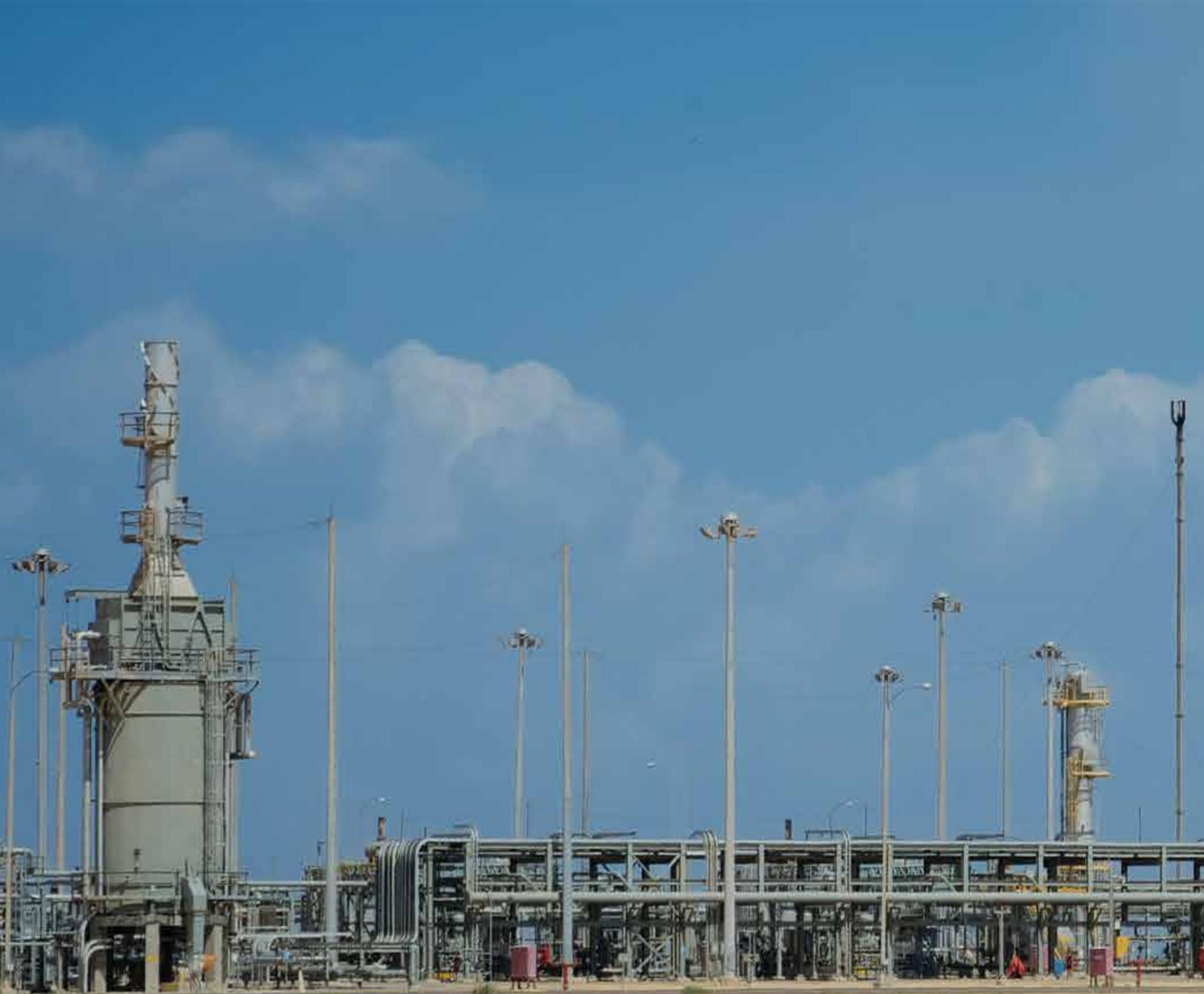
Planta de Tratamiento de Gas Tiguardare, Estado Falcón. Tiguardare Gas Treatment Plant, Falcon State.
